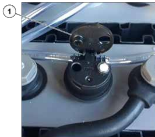
Figur 144: Kontrol af elektrolytdensiteten i højspændingsbatterierne
