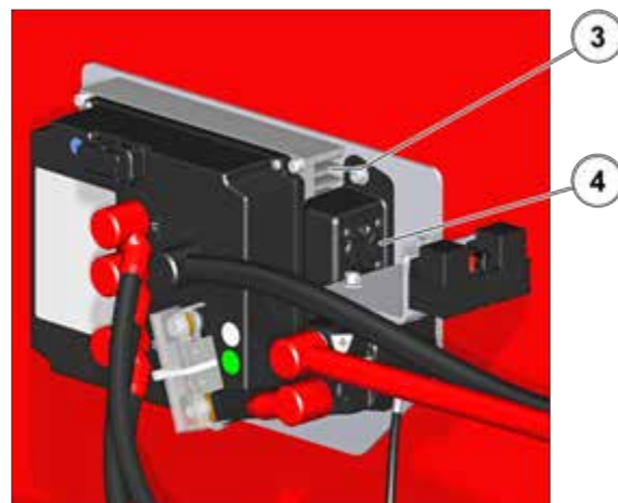
Figur 185: Rengøring af køleplader og drevventilatorer til hjulmotorer
